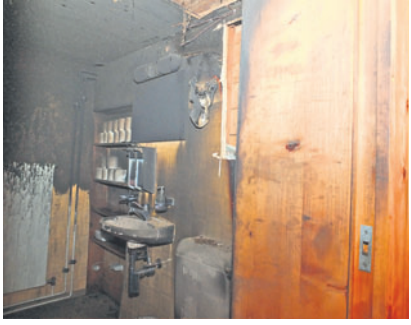
Der Brand entfachte sich in der Toilette. Die Ermittler konzentrieren sich auf einen Ventilator im Raum. (Foto: ZVG)
